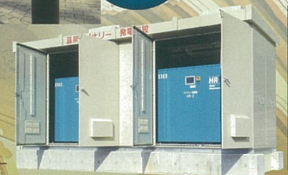
温泉バイナリー発電施設
